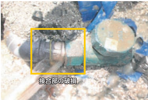
写真 給水管接合部からの漏水
